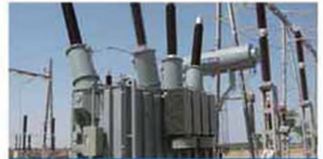
Буркина-Фасо: силовой трансформатор для Fordium
