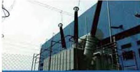
Индия: трансформатор 420kV 60MVA
