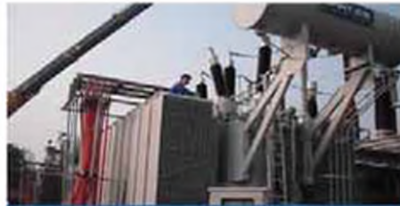
Бангладеш: силовой трансформатор для Aggreko
