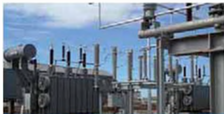
Австралия: трансформатор 132kV для ВНР
